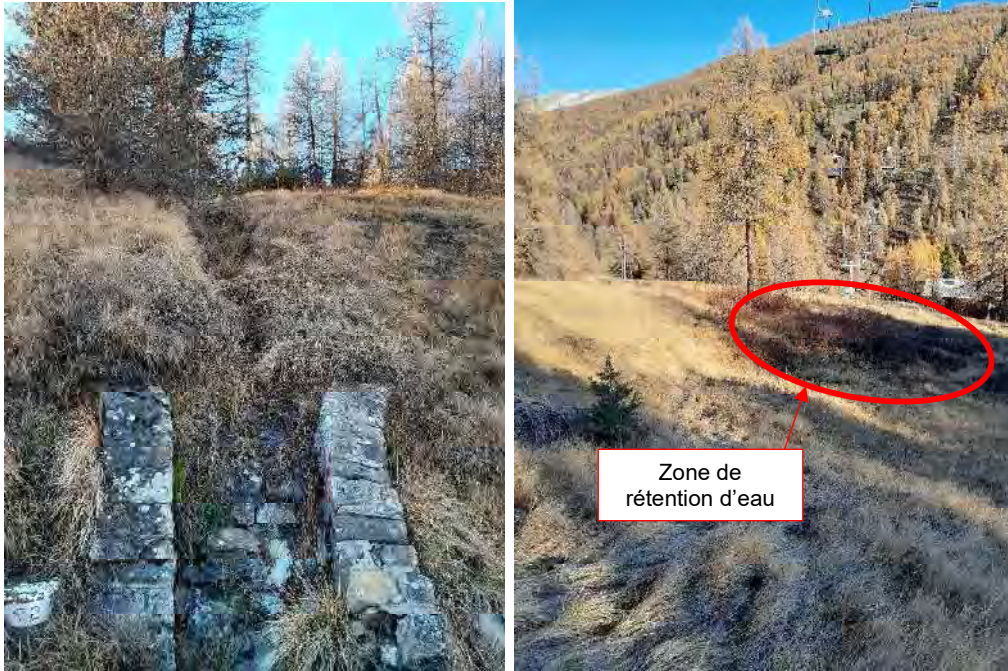
Figure 7 : Arrivée des écoulements au niveau de la route Figure 8 : Zone de stagnation d'eau vers la côte 1848m NGF.
